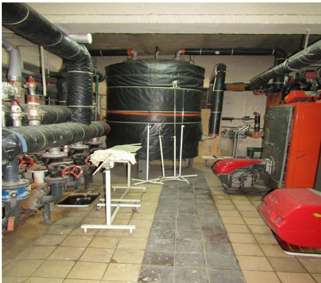
fot. 4 widok pomieszczenia kotłowni z centralnym punktem zbiornika podgrzewania cwu oraz systemem ręcznego sterowania i rozdziału ciepła dla centralnego ogrzewania
