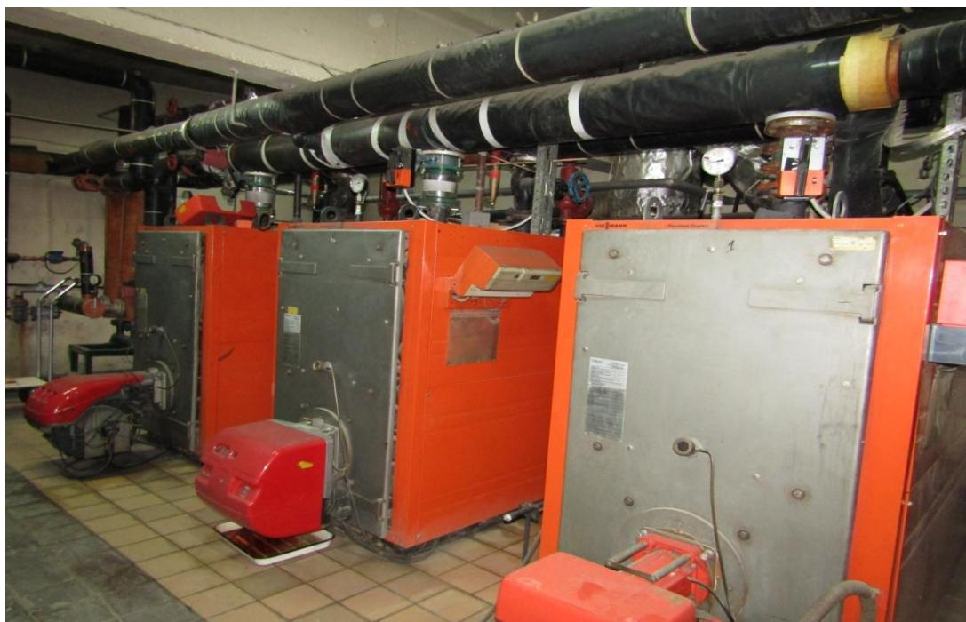
fot. 3 prezentacja zestawu kotłów grzewczych co i cwu z systemem zasileń i powrotów obiegu instalacji ciepłowniczej
