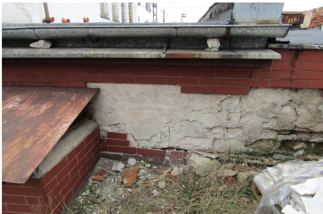
fot. 1 fragment części naziemnej budynku z widocznymi ubytkami powstałymi w wyniku wilgoci przenikającej ściany z gruntu do wewnątrz – brak izolacji pionowej i poziomej
