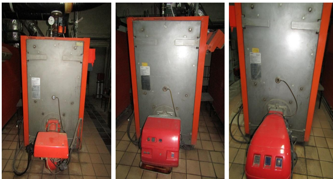
fol. 2 prezentacja zestawu kotła z palnikami olejowymi po dokonanych wymianach i adaptacjach technologicznych
