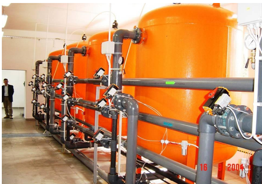
fot. 13 przykładowe zbiorniki własnego ujęcia wody ze stacją uzdatniania o wydajności do kilkuset m 3 /dobę
